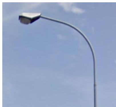
Figura 24 – Apparecchio stradale su palo curvo
