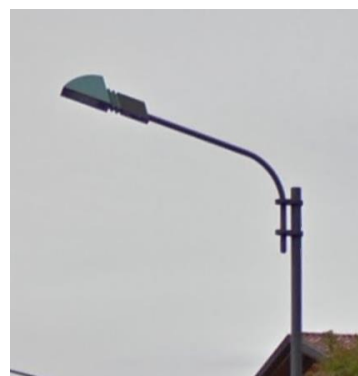
Figura 30 – Apparecchio di arredo su palo con sbraccio
