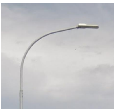
Figura 21 – Apparecchio stradale su palo curvo
