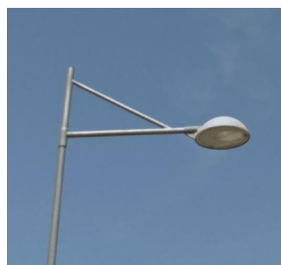
Figura 28 – Apparecchio di arredo su palo con sbraccio
