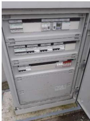
Figura 6 – Esempio scheda riepilogativa quadro elettrico
