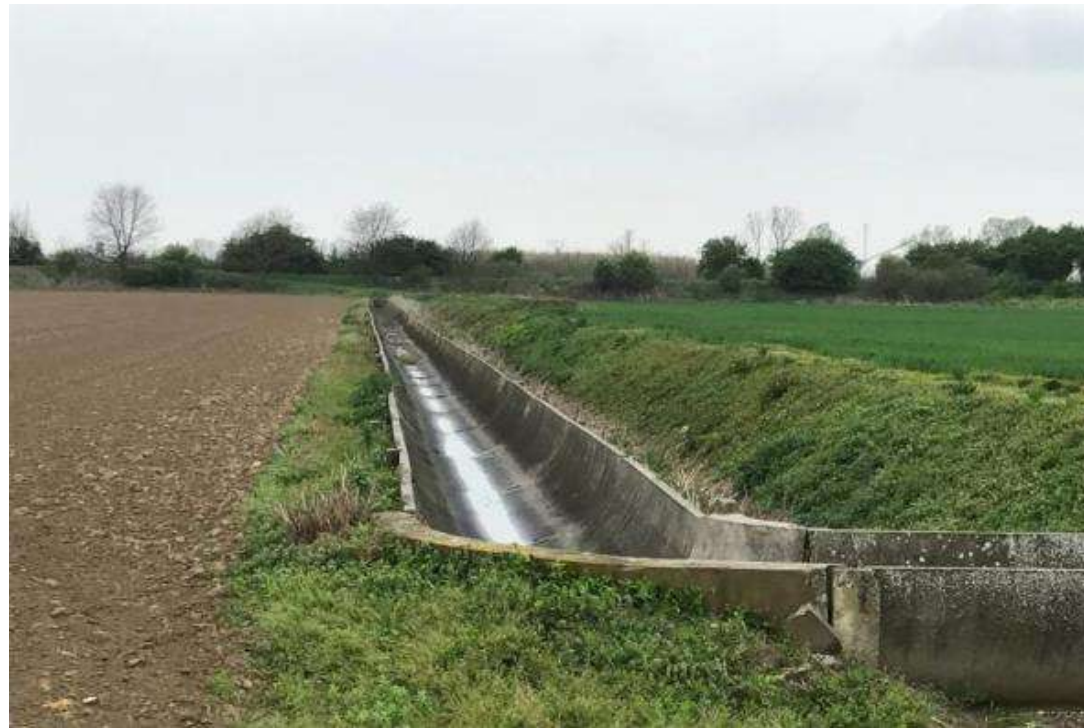
Figura 2-30: Canaletta principale della rete irrigua consorziale nella porzione sud occidentale dell'area d'intervento
