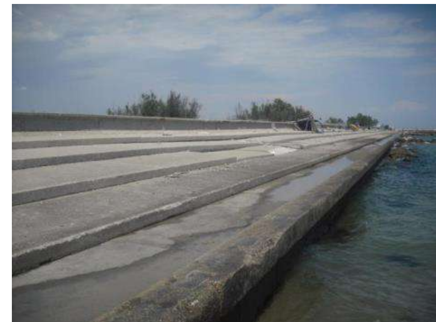
Figura 2-4: danni strutturali alla gradonata
